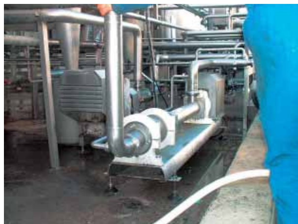
25H6 en la industria láctea para descargar aceite alimenticio en un tanque de almacenamiento.
